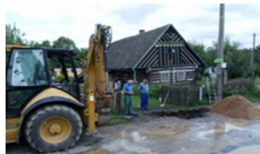
6. 6. 2019 – havárie na vodovodu
